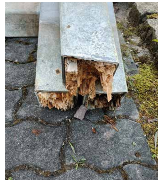
Die alte Ortstafel war baufällig und musste weichen.
